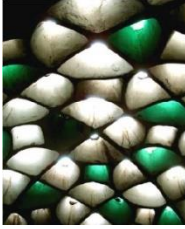
صورة ٥٧ توضح سقف إحدى الحمامات بمنزل زينب خاتون
