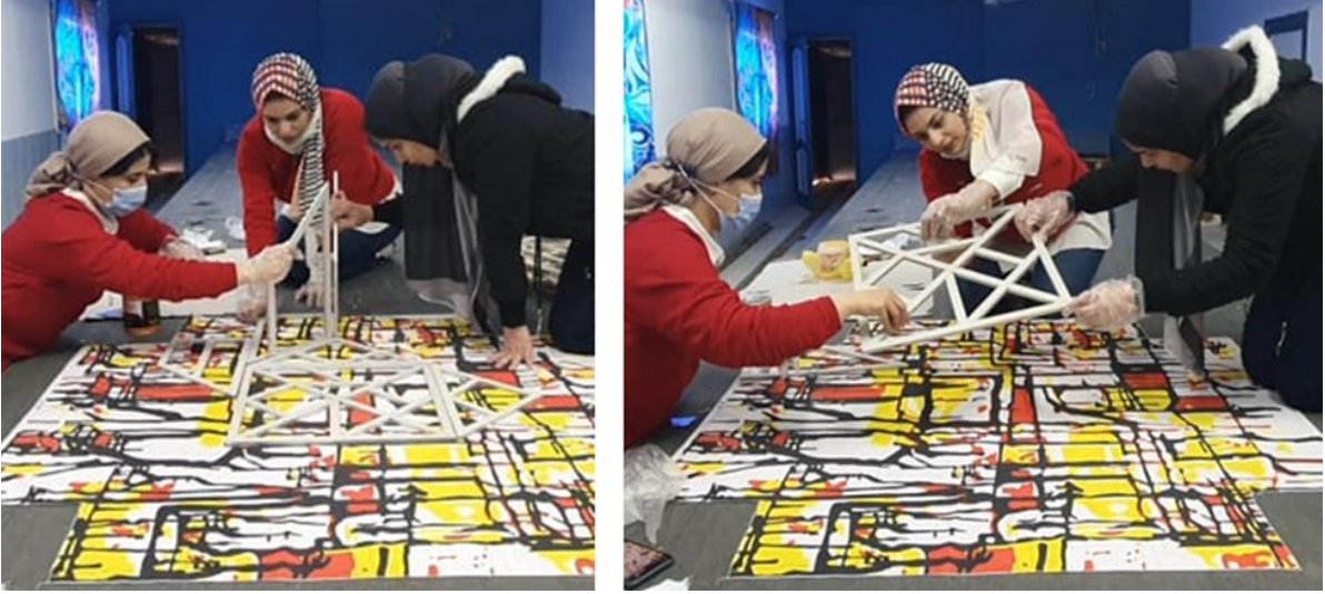
صورة رقم (٢٥) تركيب المنتج النهائي بواسطة الباحثين في ورشة قسم طباعة المنسوجات كلية الفنون التطبيقية جامعة دمياط.
